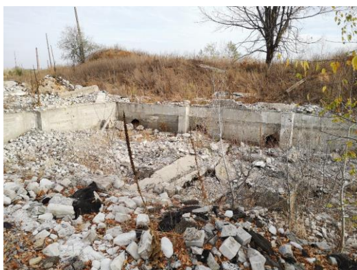
Рисунок 8. Зруйновані споруди колишнього виробництва
