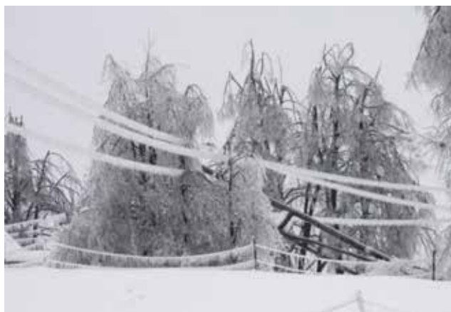
Рис. 31. Поврежденные воздушные линии электропередачи.
