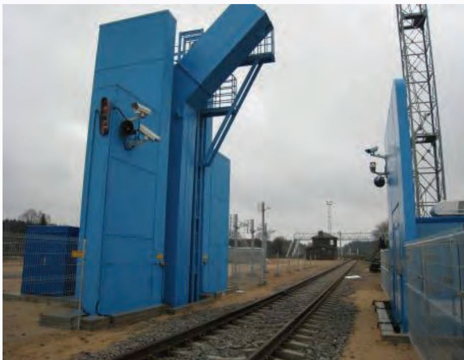
Неподвижный сканер РЕНТГЕНА на железнодорожной станции, Copyright © UIC
