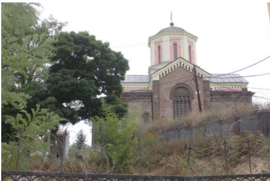
SRPSKA PRAVOSLAVNA CRKVA SVETI SAVA U JUŽNOJ MITROVICË/MITROVICI, KOJA JE IZGRAĐENA IZMEĐU 1896. I 1912, UNIŠTENA JE TOKOM NEMIRA U MARTU 2004. KOMISIJA ZA SPROVOĐENJE OBNOVE SAVETA EVROPE KOJA JE OSNOVANA DA BI SE PONOVO IZGRADILI VERSKI I KULTURNI OBJEKTI NASTRADALI U DOGAĐAJIMA IZ 2004. JE ZAPOČELA OBNOVU 2007.
