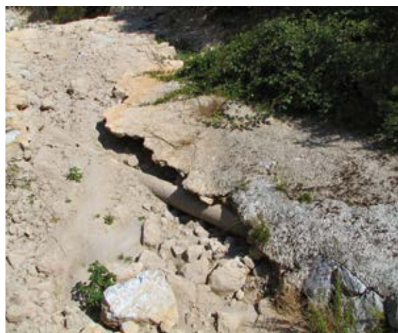
Slika 40: Oštećenja cevodova duž trase kroz Koritničku reku
