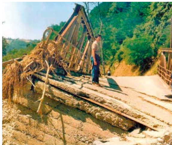
Slika 35: Teško oštećen most na reci Tegošnici
