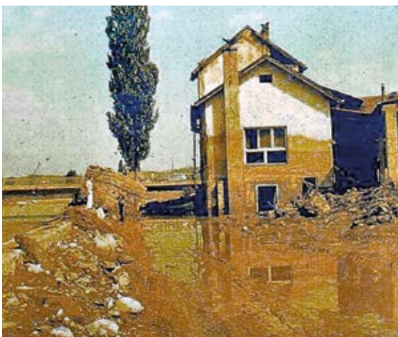
Slika 36: Trag bujice i betonski deo probijene brane u Vlasotincu. Bujica je probila put na suprotnoj strani od mosta
