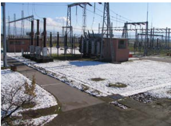
Slika 16: Velika trafostanica koja snabdeva strujom značajan deo Srbije
