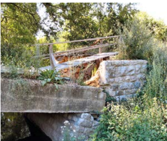
Slika 39: Most na Koritničkoj reci srušen tokom poplave
